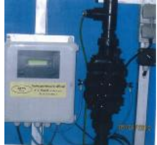
Steuerung Photo ATYS ATS SA
